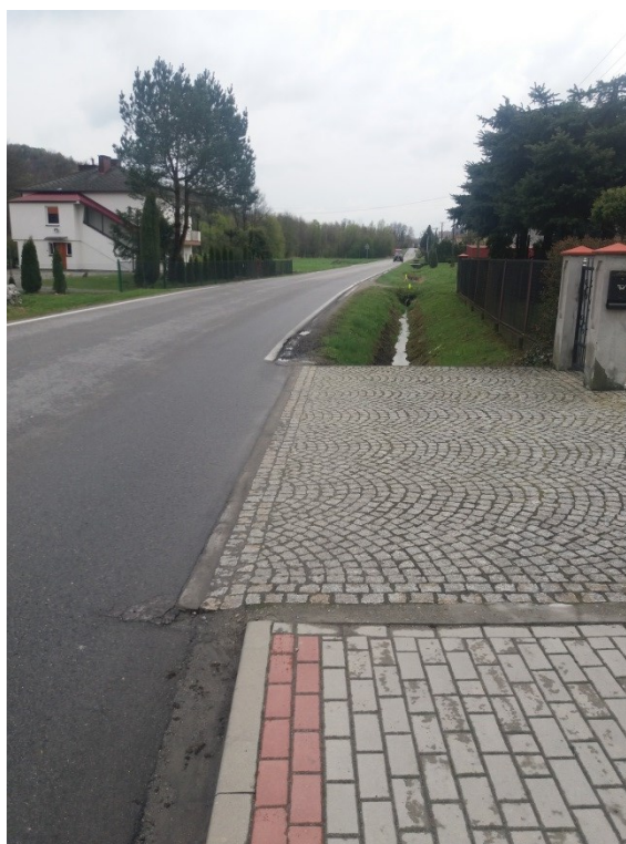
Fotografia 3 Zakończenie chodnika w Dołach – brak spójności z pozostałym odcinkiem chodnika
